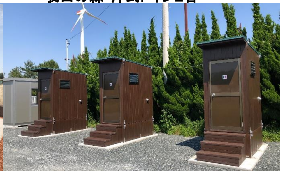
★愛知県知多市 多目的グラウンド 水洗式トイレ3台
